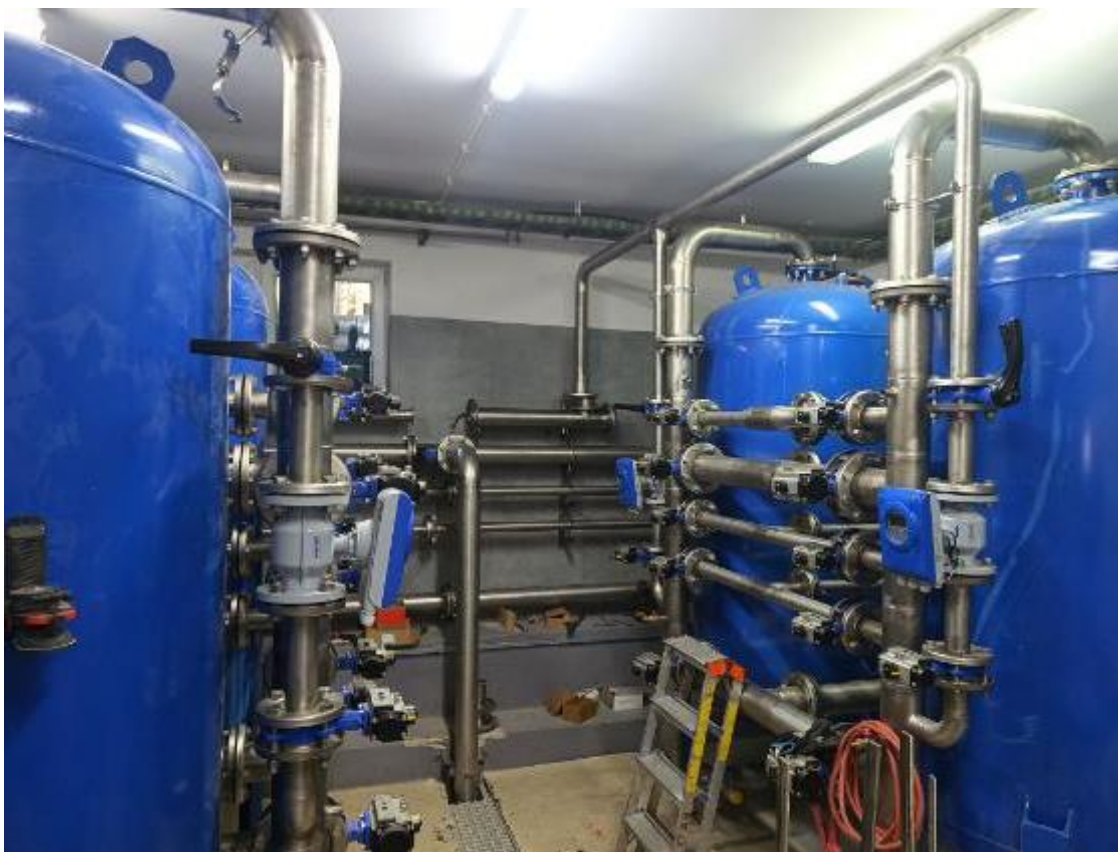
Zdjęcie zmodernizowanej pompowni
